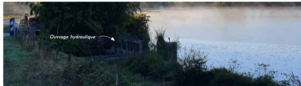
Vue des ouvrages hydrauliques non-exploités de l'étang de Pierre au Grain, Pressy-sous-Dondin
