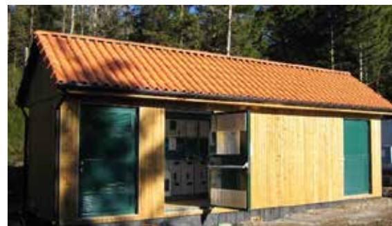
Exemple de poste de livraison. Source : https://parc-eolien-plaine-de-champagne.fr/poste-de-livraison-2/
